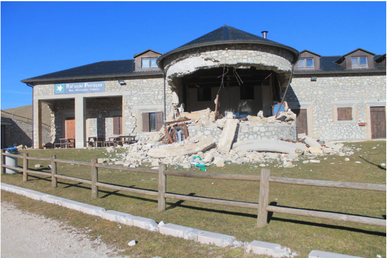
9- Il Rifugio Perugia, l'evidente errore costruttivo di un pesante cordolo in cemento armato sopra un muro di pietre non
